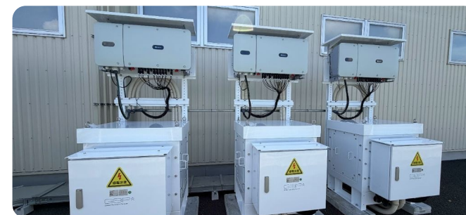
トランス+PCS 屋外設備
