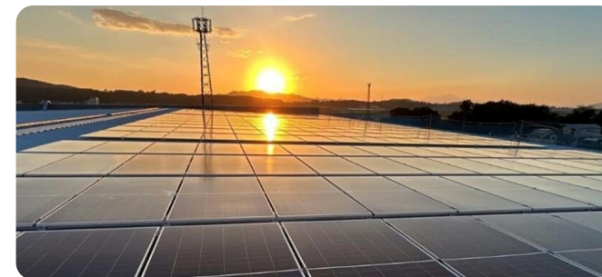
折板屋根 2MW ハゼ式（物流倉庫）
