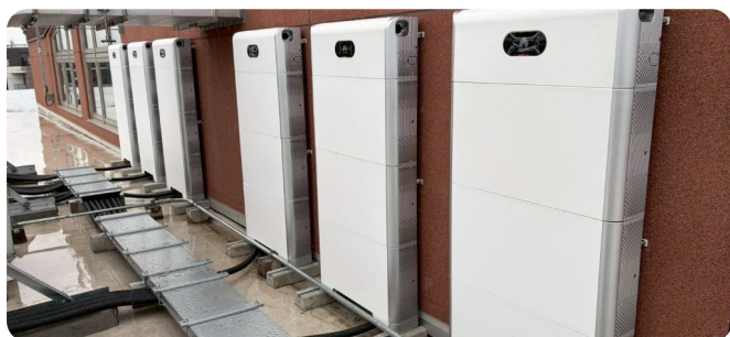
蓄電池設備 低圧連系
